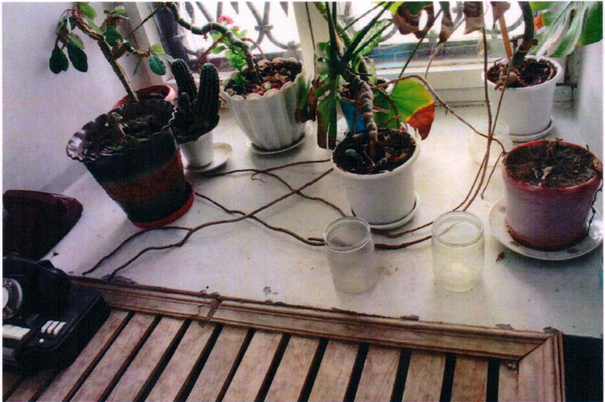
Фотофиксация нарушений отделочного слоя подоконников.
