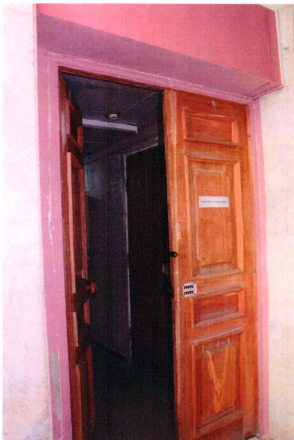
Фотофиксация нарушения отделочного слоя дверных проемов.
