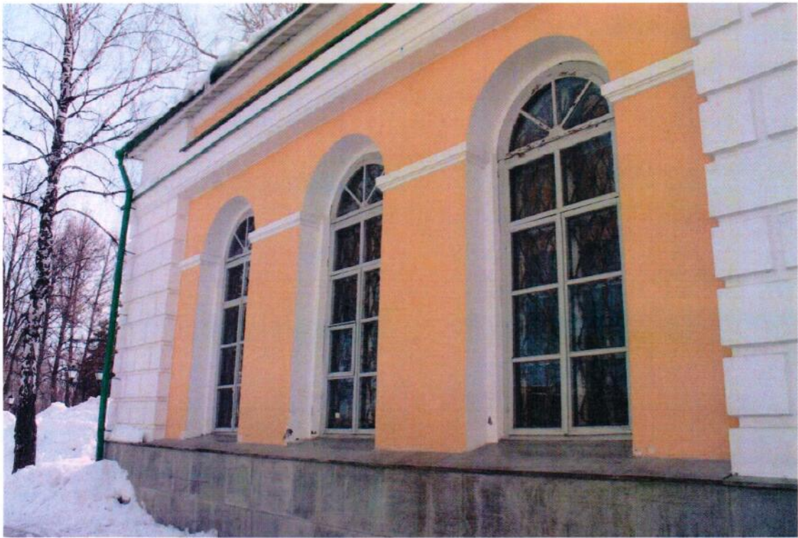
Фотофиксация нарушения отделочного слоя оконных рам.
