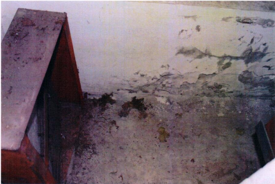
«Вент-камера». Фотофиксация нарушения отделочного слоя стен.
