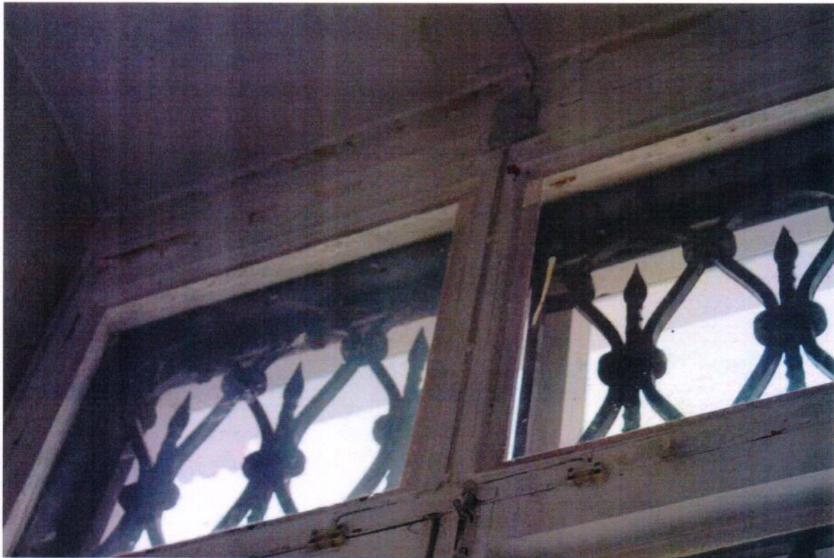
Фотофиксация нарушения отделочного слоя оконных рам.
