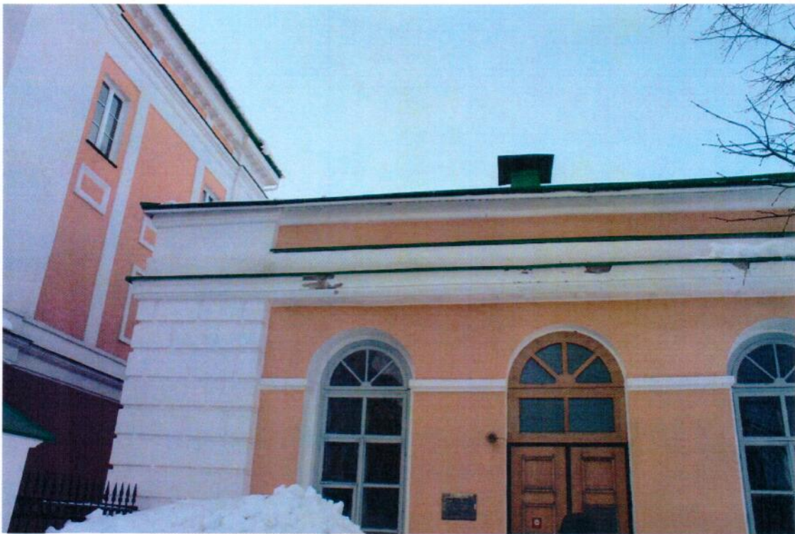
Фотофиксация нарушения отделочного слоя декоративных элементов (карниз).
