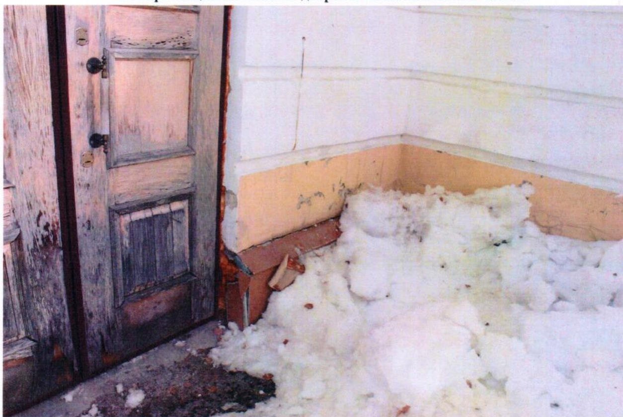
Фотофиксация намокания дверей и гниения нижних частей, нарушение отделочного слоя цоколя, фасада.
