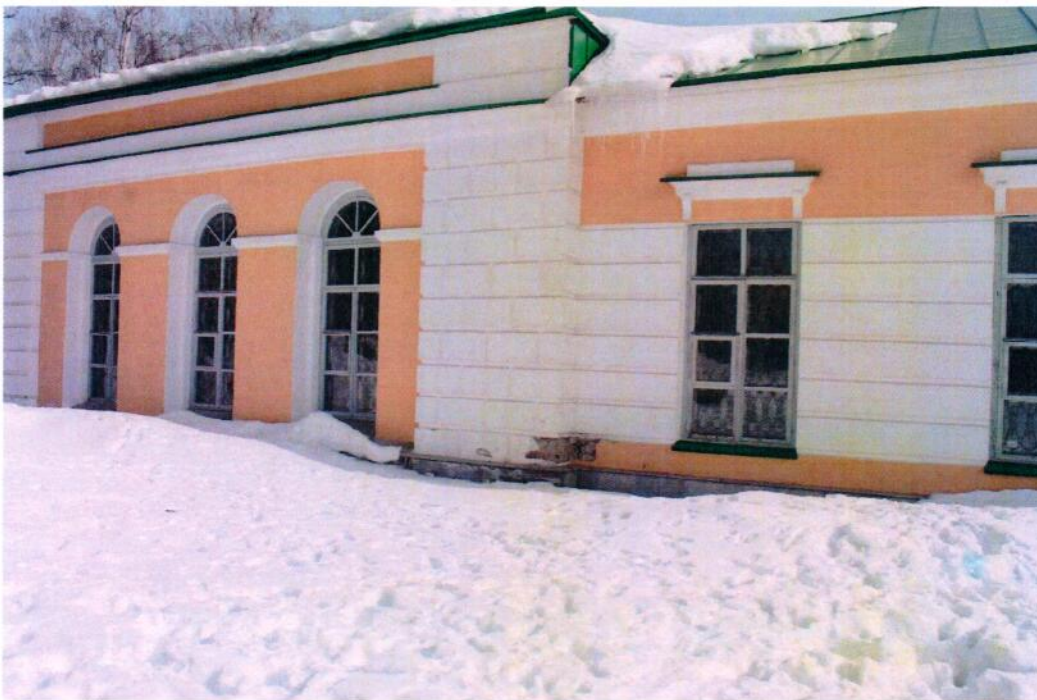
Фотофиксация нарушения отделочного слоя фасадов, декоративных элементов, цоколя.
